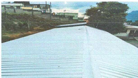
Foto1: TECHO EN MAL ESTADO
