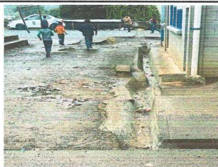
Foto 6: ALCANTARILLADO EN USO
